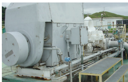
Bomba RP 37 ee+ee, operando em campo antes do retrofit
